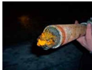
Afbeelding 3: stalen pijp die geheel 'geplugd' is door corrosieproducten (foto MIC Europe b.v.).
